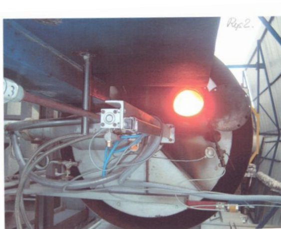
Rys.2. Płyta czołowa komory obrotowej.
