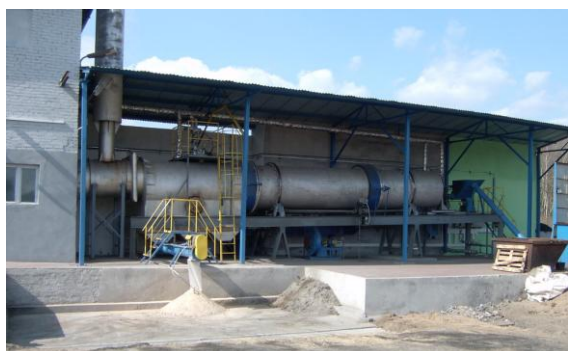
Rys.4. Komora obrotowa- ogólny widok instalacji.
